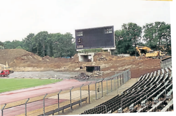
Mit 24.000 Zuschauern wird sie gegen Mainz 05 schon ausverkauft sein: die Baustelle Waldstadion. Fotos: Eintracht-Archiv
